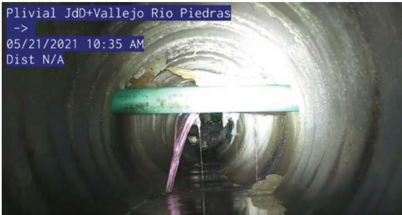
Figura 7. Sistema sanitario y pluvial interconectado. La tubería verde corresponde a las líneas sanitarias, mientras que la tubería gris corresponde al sistema pluvial. En este caso se utilizó un colorante para identificar el origen de la contaminación de las aguas sanitarias (Imagen obtenida de una presentación del Dr. Gustavo Martínez, 2023).
