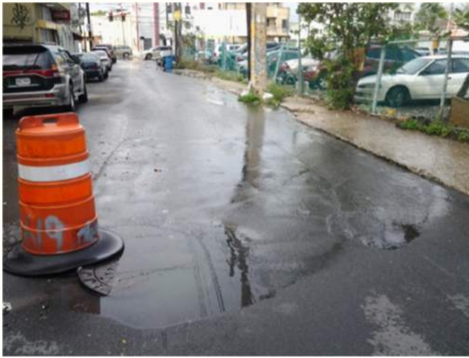
Figura 2. Desbordamiento de aguas sanitarias en los registros de las alcantarilla de sistema sanitario.
