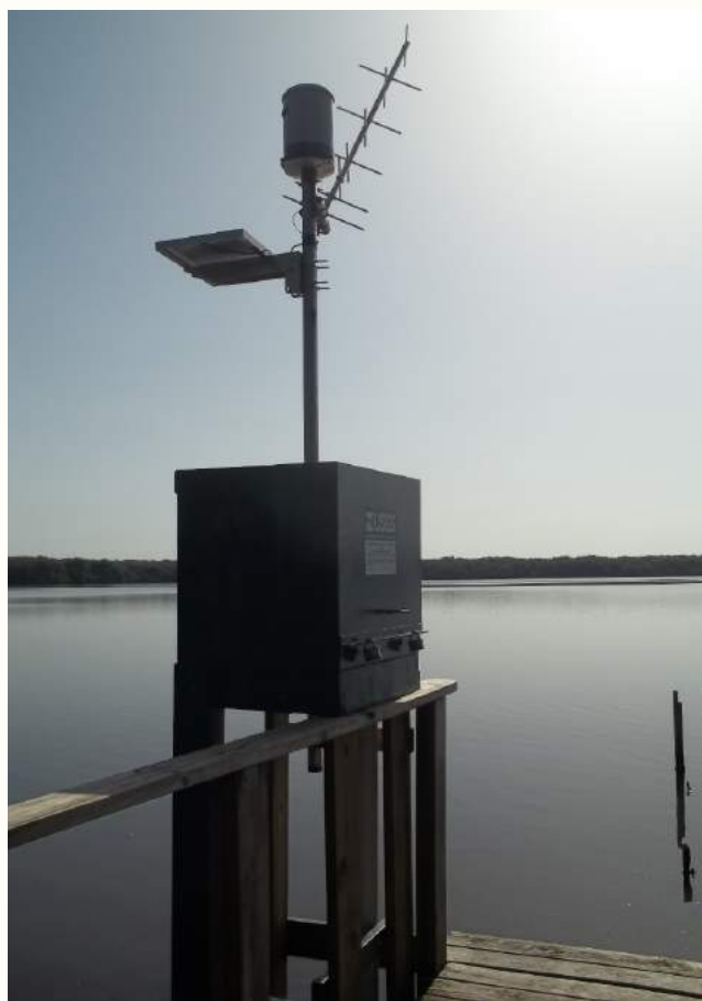
Figura 1. Estación para medir el nivel del agua en superficie instalada en la Laguna Piñones.
