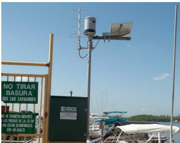
Figura 3. Estación para medir el nivel del agua en superficie instalada en la Laguna La Torrecilla.
