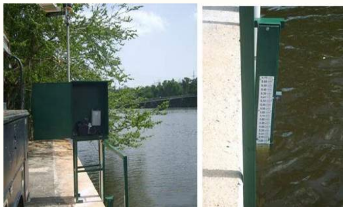
Figura 4. Estación para medir el nivel del agua en superficie instalada en Caño Martín Peña.
